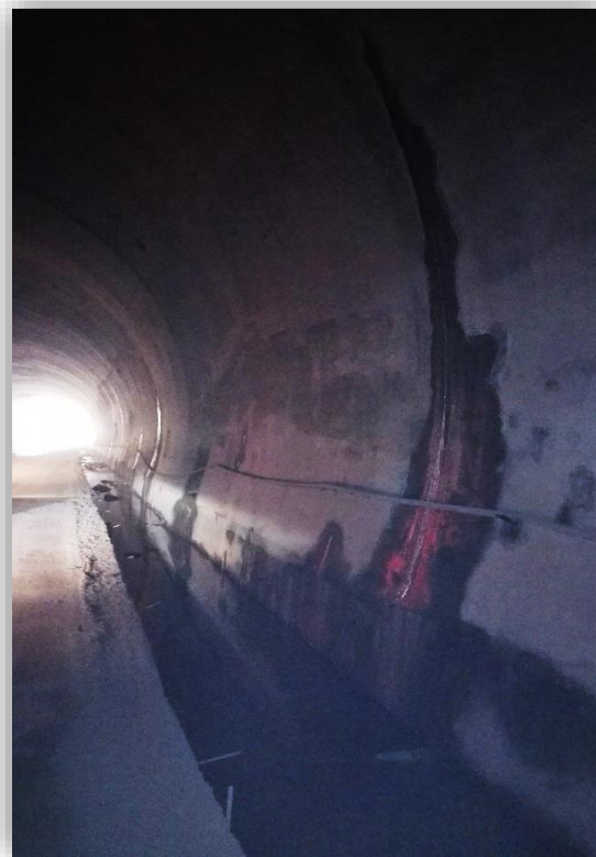
نشست فشار منفی آب از درزهای سرد، تونل و کانال‌های دسترسی
