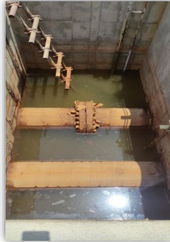
نفوذ فشار منفی آب و تخریب شیمیایی و فیزیکی بتن و تاسیسات
