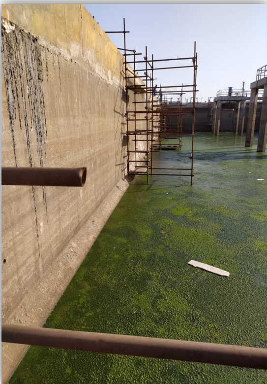
نشست آب و تخریب شیمیایی مخازن بتنی
